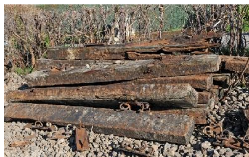
Für den Eisenbahnbetrieb nicht mehr zu gebrauchen.
